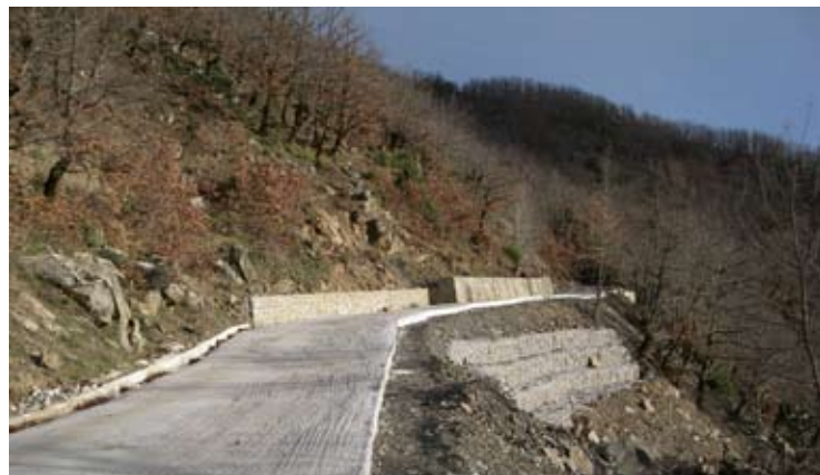
Ακριβώς αυτά τα έργα απαιτούμε να γίνουν και στον κάτω δρόμο για να αποκατασταθεί η κατολίσθηση
