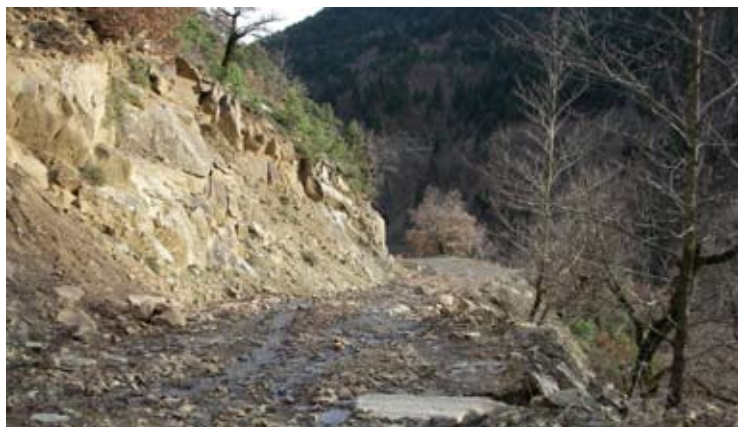
Κατάσταση οδοστρώματος του τμήματος Νεραΐδα-Γιαννουσεΐκα, του οδικού άξονα Καρπενήσι- Λίμνη Πλαστήρα
