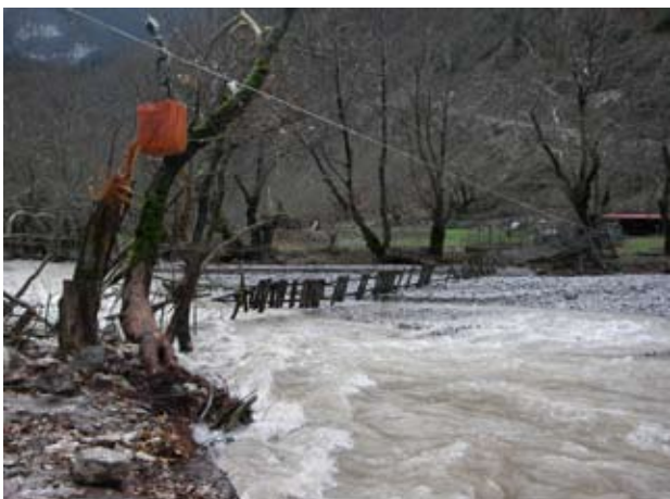
Το γεφύρι στον Μέγδοβα "Μπεσιώτη" μετά την καταστροφή
