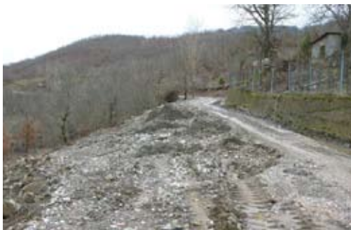
Θέση «Γούρνες». Εδώ πρέπει επείγοντως να επισκευαστεί η ζημιά.
