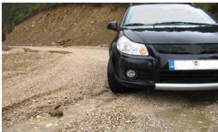
Τα όμβρια νερά τρέχουν μέσα στο δρόμο Νεράϊδα – Τριφύλλα καταστρέφοντας το οδόστρωμα καθώς τα αυλάκια – τεχνικά δεν λειτουργούν.
