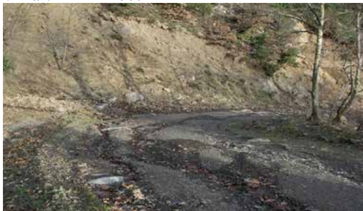
Τεχνικό βουλωμένο (άλλο) στο δρόμο Νεράϊδα – Μοναστήρι και το ρέμα τρέχει μέσα στο οδόστρωμα καταστρέφοντάς το. Πότε θα το ξεβουλώσουν οι αρμόδιοι;
