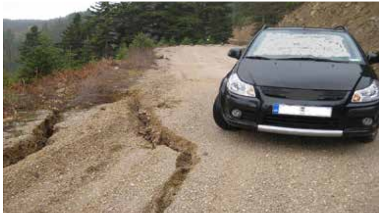
Το οδόστρωμα του δρόμου Νεράϊδα – Τριφύλλα έχει καταστραφεί σε πολλά σημεία καθώς τα αυλάκια – τεχνικά δεν λειτουργούν και τα όμβρια τρέχουν μέσα στο δρόμο.
