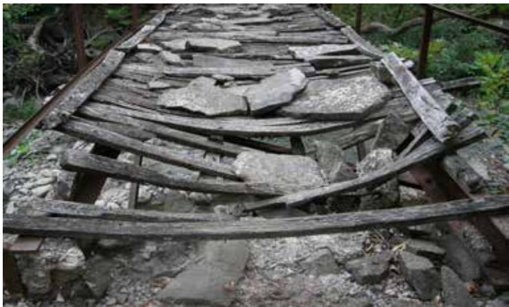
Το δάπεδο του γεφυριού «Τσιροπλάκι» φθαρμένο. Ήδη άρχισαν διαδικασίες να το ξαναφτιάξουμε με εθελοντική εργασία.
